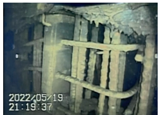
Рис.2. Обнажившаяся стальная арматура пьедестала и застывшие ТСМ на 1-м блоке.
